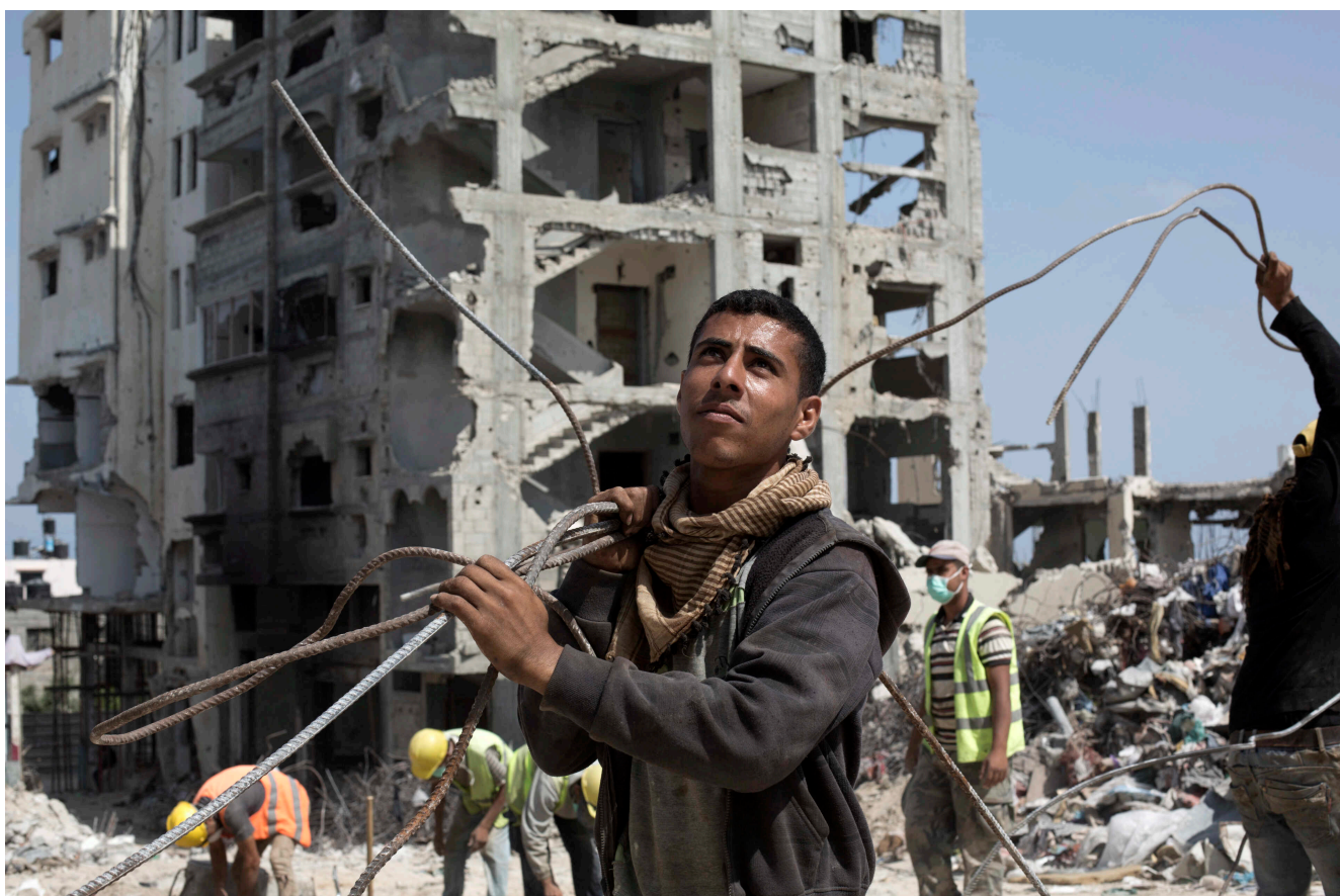
Des ouvriers palestiniens retirent des morceaux de ferraille des décombres d'un bâtiment détruit lors de l'opération israélienne « Bordure protectrice », à l'été 2014, dans le quartier de Shujayya, dans l'est de la ville de Gaza, le 2 juillet 2015.
